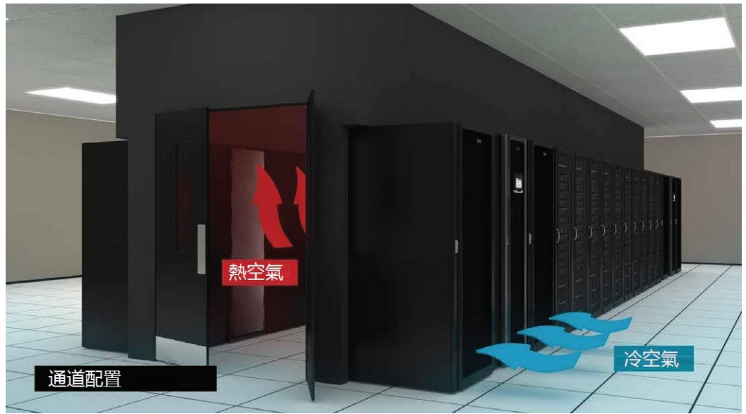
ePDU 設置於熱空氣排放區域的現代熱空氣隔絕方案
